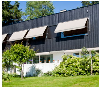
Vindusmarkiser med sol- og vindautomatikk.
